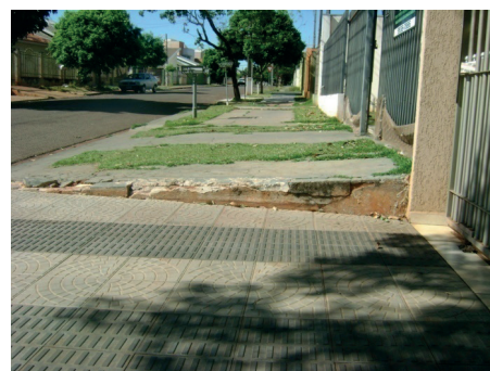
Imagem 3 – Rampa na calçada fora de padrão
