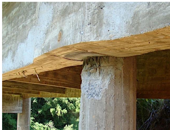
Figura 20: sinais de esmagamento do concreto ( F_i = 4 )
