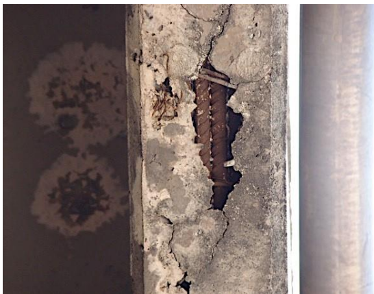
Figura 1: corrosão de armadura ( F_i = 2 )
