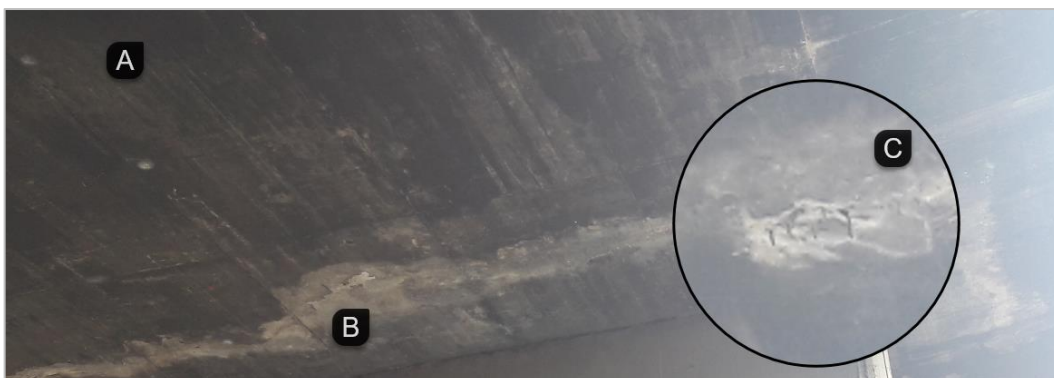
Figura 14 – Laje OAE 11: (A) manchas escuras; (B) manchas brancas devido a lixiviação do hidróxido de cálcio; (C) formação de estalactites.
