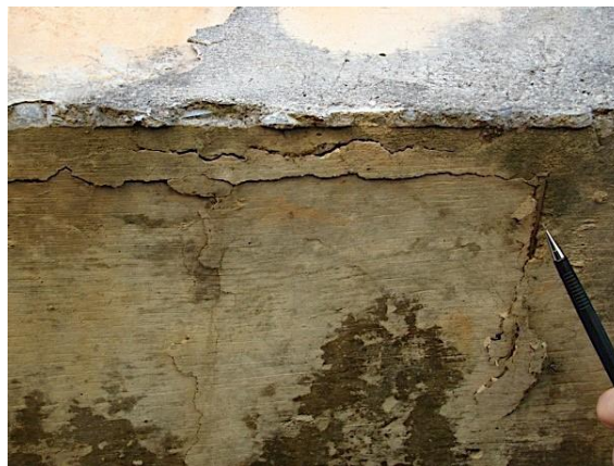
Figura 2: corrosão de armadura ( F_i = 3 )
