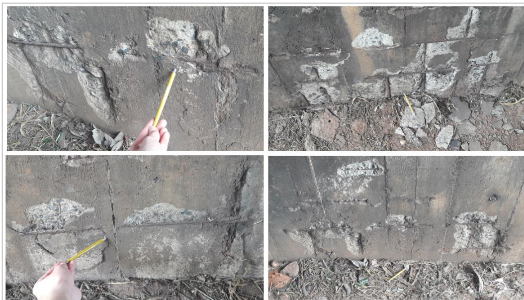
Figura 19 - Pilares com corrosão e armaduras expostas.
