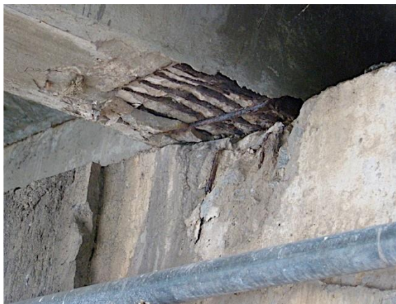
Figura 19: sinais de esmagamento do concreto ( F_i = 3 )
