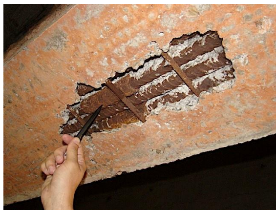
Figura 14: falha de concretagem ( F_i = 3 )
