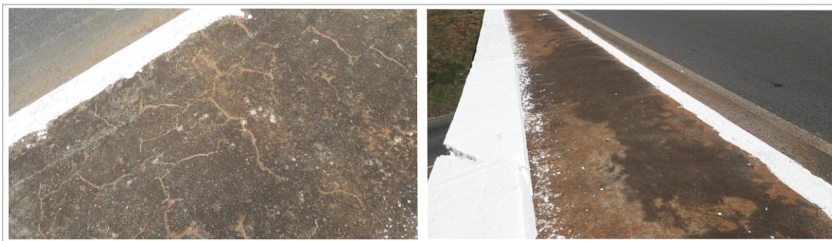
Figura 22 - Calçada superior OAE 13
