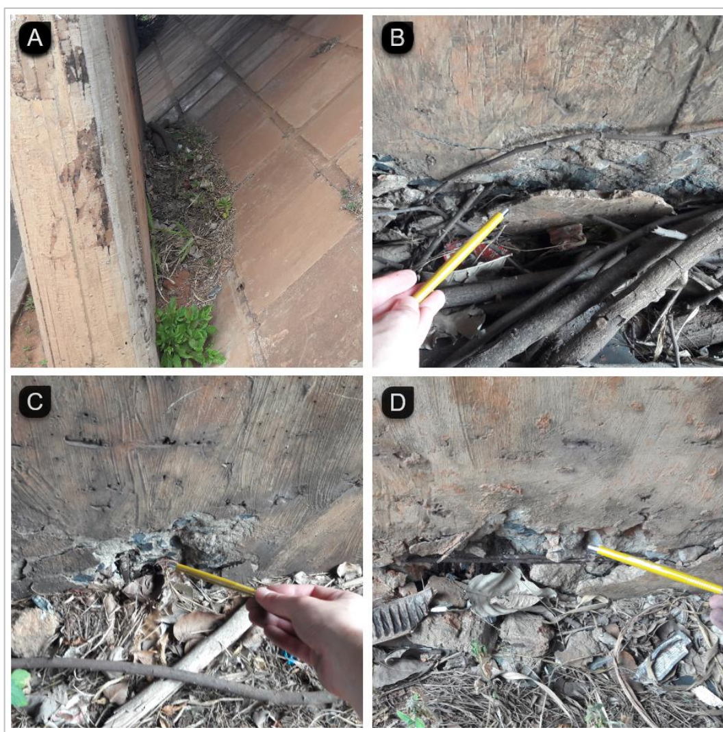
Figura 15 - Pilares OAE 11: (A) detritos entre o pilar e o aterro; (B) deslocamento devido a corrosão; (C) e (D) Armadura exposta, deslocamento e corrosão.
