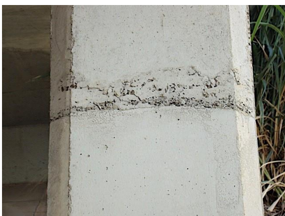
Figura 11: falha de concretagem ( F_i = 1 )
