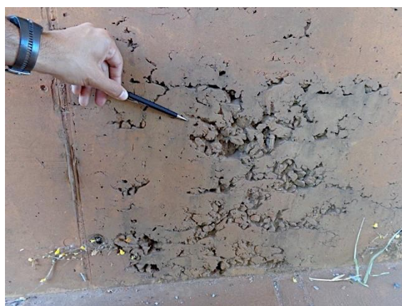
Figura 12: falha de concretagem ( F_i = 2 )
