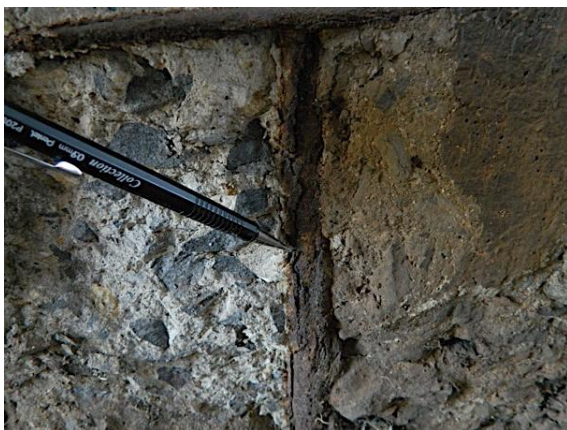
Figura 3: corrosão de armadura ( F_i = 4 )
