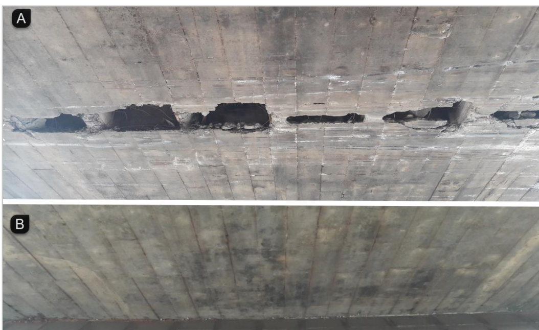
Figura 18 - Laje OAE 12: (A) impactos na estrutura; (B) manchas escuras.
