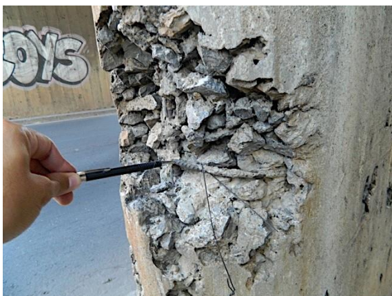
Figura 13: falha de concretagem ( F_i = 3 )
