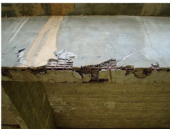
Figura 15: falha de concretagem ( F_i = 4 )
