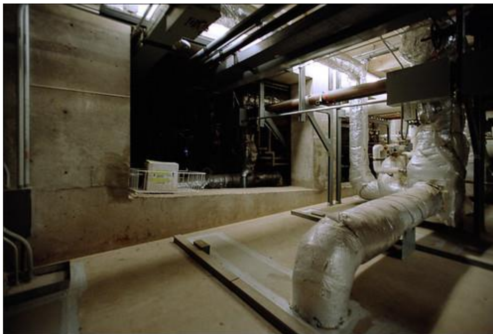
Figura 36 – Fotografia do pavimento intersticial constituído pelas grandes vigas Vierendeel e as instalações. Fonte: Xavier de Jauréguiberry
