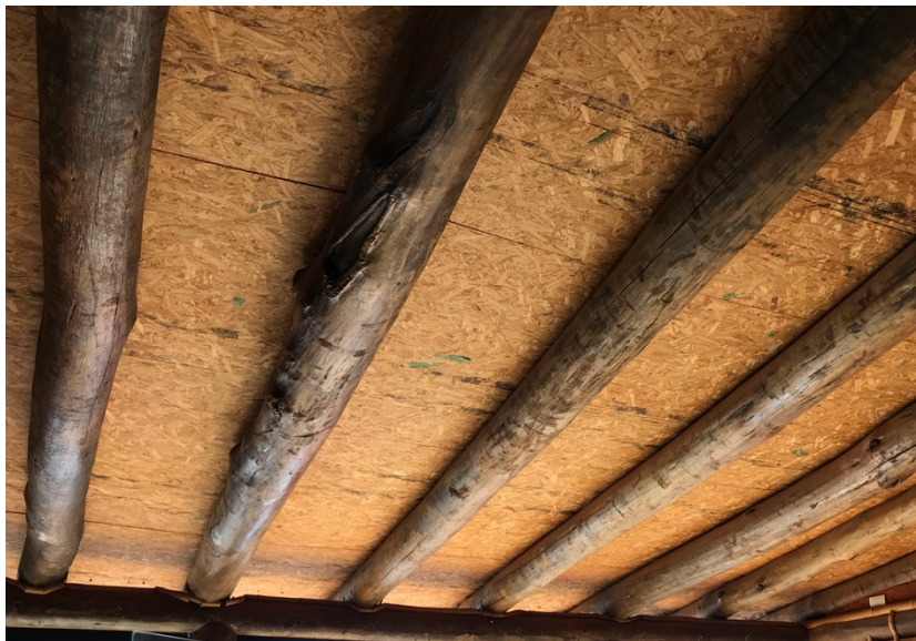
Figura 33 - Estrutura do telhado deteriorada por infiltração
