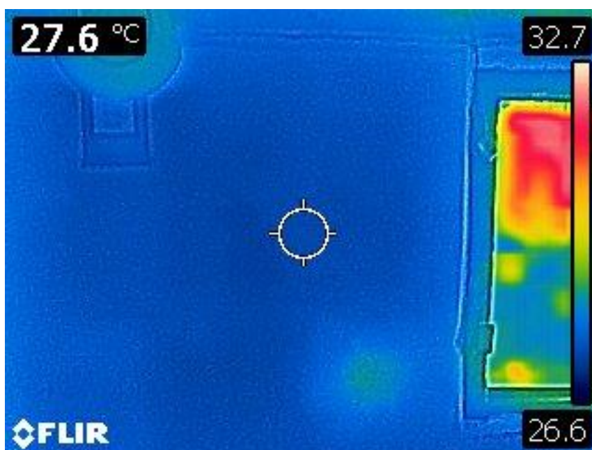
Figura 8- Parte interna da parede posterior, foto termográfica. (Fonte: Própria)
